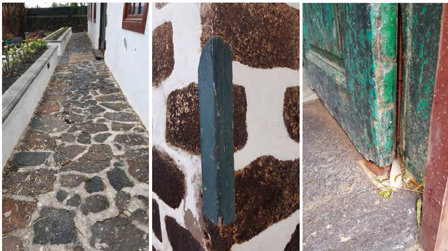
VILLA DOLORES. 1. ACCESO EMPEDRADO ORIGINAL. 2. ELEMENTO DE MADERA PROTECTOR DE ESQUINA. 3. DETALLE INFERIOR DE PUERTA CON GOZNE Y QUICALERA. FOTO: DOLORES GONZÁLEZ
